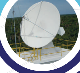
ESTÇÃO DE TELEMEDIDAS BANDA S (ST2233)
